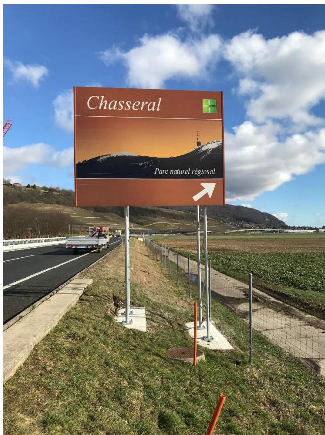
Panneau installé sur l'A5 à Cressier, sortie Le Landeron (NE) © Signal SA
